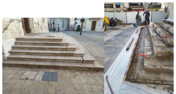
Hôtel de ville et Mairie Mauguio : Mise aux normes des escaliers et des sanitaires sur l'ensemble du site. Mise aux normes
