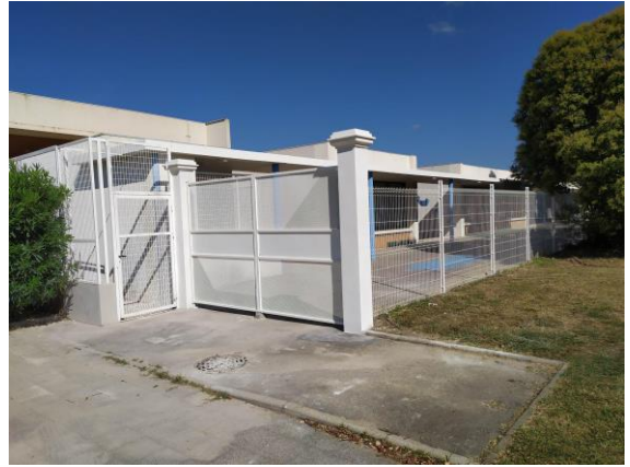
Centre Administratif de Carnon : Mise aux normes des sanitaires du RDC, des escaliers et création d'un accès conforme à la terrasse de la médiathèque de l'Ancre
